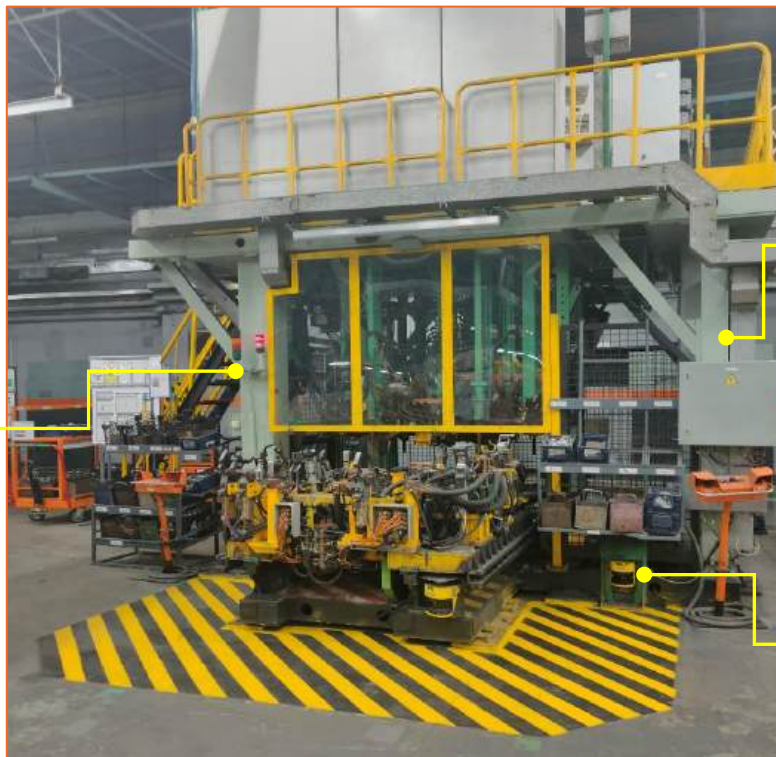
Изготовлены и установлены защитные ограждения, датчики 4-го типа, лазер-сканеры, нанесена сигнальная разметка, реализована процедура LOTO.
